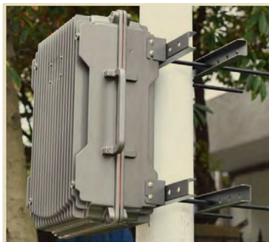
图 6 室外固定台实物室外安装图
